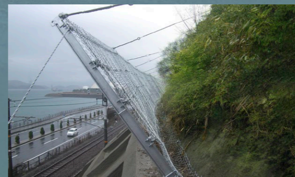
【法肩部】 線路への落石防止
