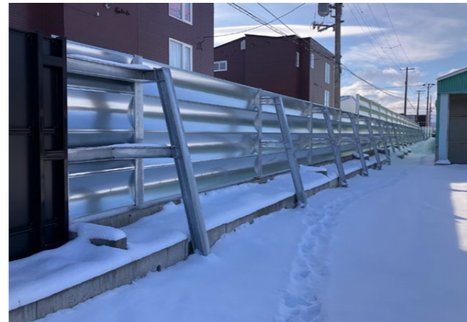
設置状況 (敷地内側)
